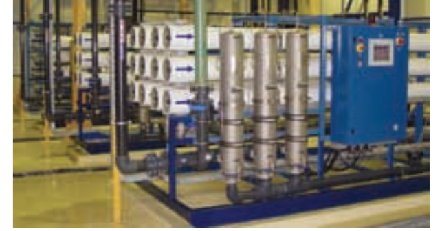
ENTEK Enerji Santrali Desalinasyon Tesisi
