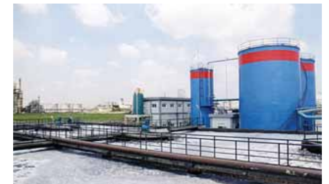
SASA Sentetik Elyaf ve İplik Atık Su Arıtma Tesisi, Adana - Türkiye (Kapasite: 26.000 kgKOl/gün, 215.000 E.N.)
