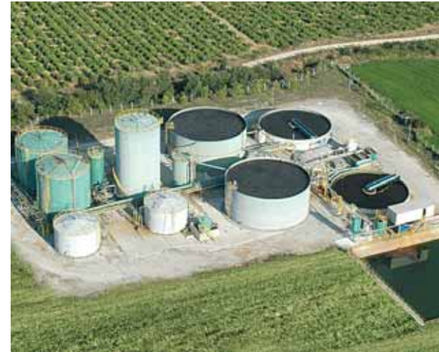
Cargill Şeker Fabrikası Atık Su Arıtma Tesisi - Bursa, Türkiye (Kapasite: 23.000kgKOl/gün, 190.000 E.N.)
