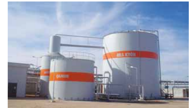
MB Şeker Fabrikası Atık Su Arıtma Tesisi, Aksaray - Türkiye (Kapasite: 30.000 kgKOl/gün, 250.000 E.N.)
