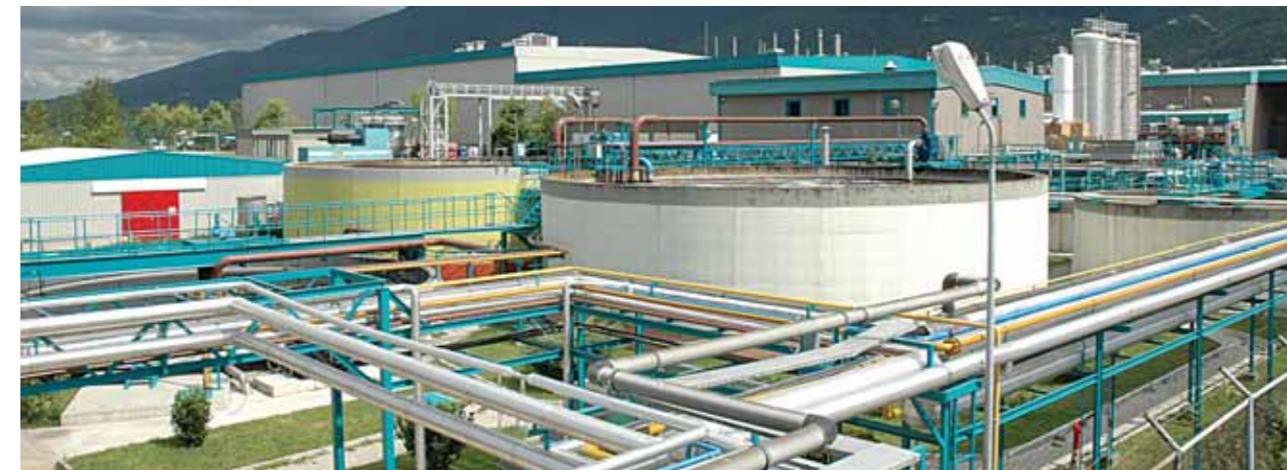
Pepsi Co Gıda - Frito Lay Atık Su Arıtma Tesisi, İzmit - Türkiye, (Kapasite: 28.000kgKOl/gün, 230.000 E.N.)
