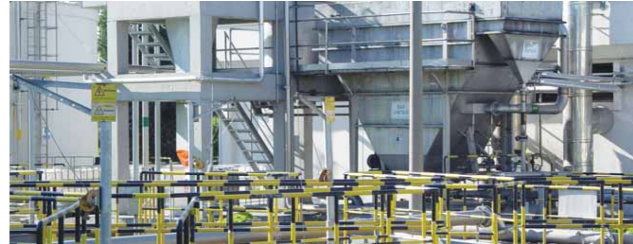
Cadbury Schweppes Atık Su Arıtma Tesisi, İstanbul-Türkiye, DAF Ünitesi (Kapasite: 14.850kgKOl/gün, 120.000 E.N.)
