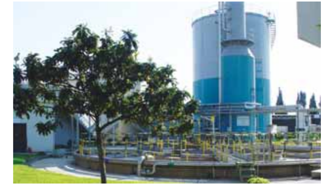
Cadbury Schweppes Atık Su Arıtma Tesisi, İstanbul - Türkiye Anaerobik Reaktör (Kapasite: 14.850 kgKOl/gün, 125.000 E.N.)
