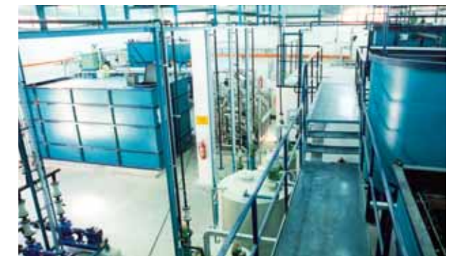
Ford Otosan Fabrikası Atık Su Arıtma Tesisi, Aksaray - Türkiye Kapasite: 336 m 3 /gün, Proses: UF-Kimyasal Arıtma-Biyolojik Arıtma-Çamur Susuzlaştırma
