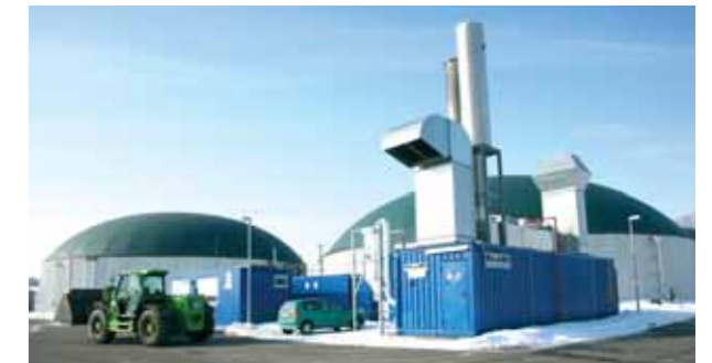
1.200 kWe Biyogaz Tesisi (enerji bitkisinden)
