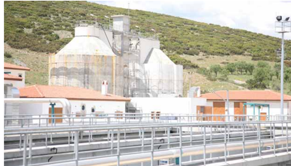
Muğla Belediyesi Atık Su Arıtma Tesisi çamur çürütme ve enerji geri kazanım tesisi Kapasite: 2 x 2500m 3 reaktör, 375 kWe biyogaz motoru
